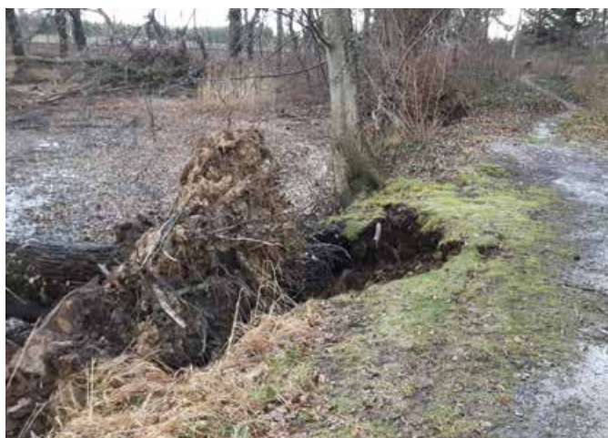
Dammschaden Kleiner Rummel
